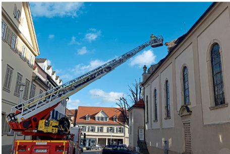
Bei der katholischen Dreieinigkeitskirche am Marktplatz muss die Feuerwehr das Dach sichern – ein paar Ziegel haben sich gelöst und sind nach unten gefallen. Der Platz um die Kirche war auch gestern noch abgesperrt.
