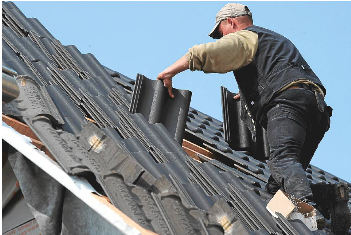
Eine Schwachstelle nach all den Jahren: Das Hausdach ist permanent Witterungseinflüssen ausgesetzt. Nach 30 Jahren können Dachziegel gerissen oder locker sein.
